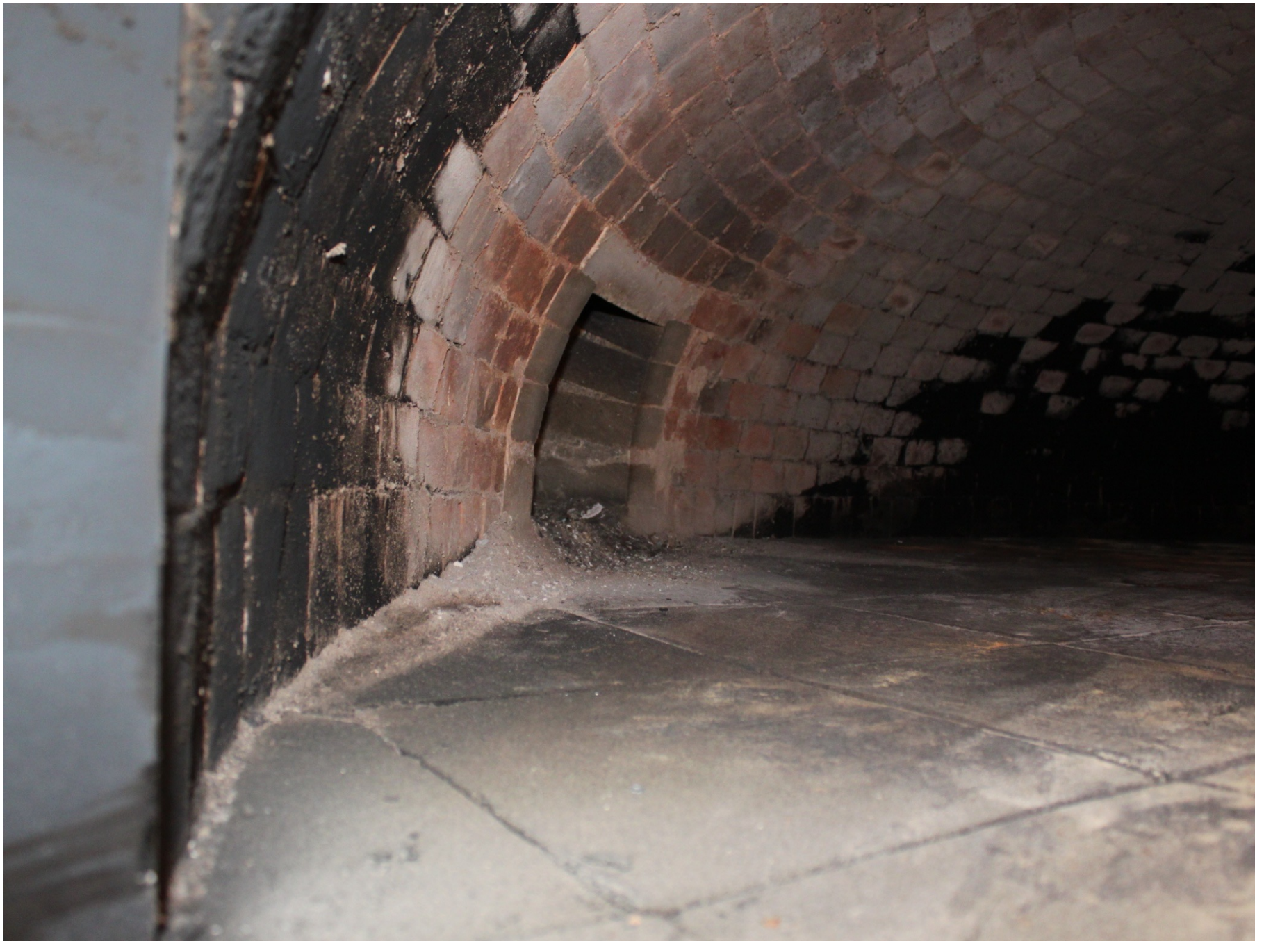
L'entrée de la flamme dans la chambre de cuisson, ou gueulard permanent.
